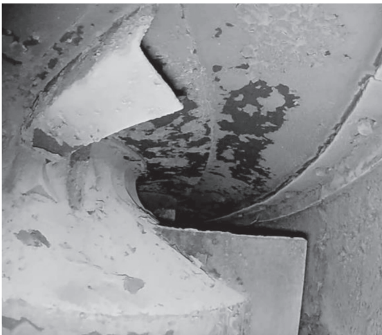
写真2 塔槽類における静止画
